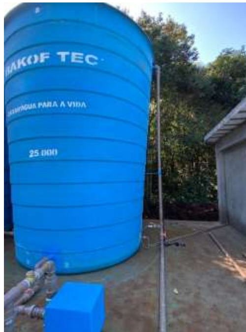
Figura 07 – Tanque de água tratada Bakof Tec.
