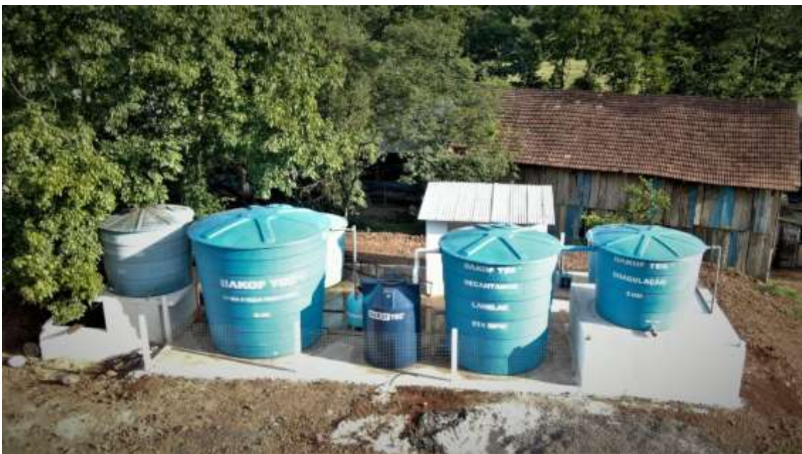
Figura 01 – Estação de Tratamento de Água Bakof Tec.
