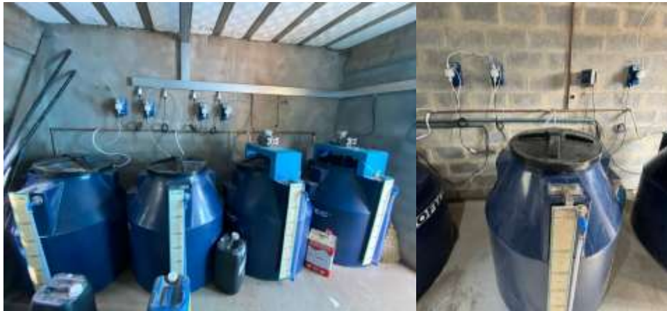
Figura 08 – Tanques de diluição e preparo de produtos químicos, e bombas dosadoras.
