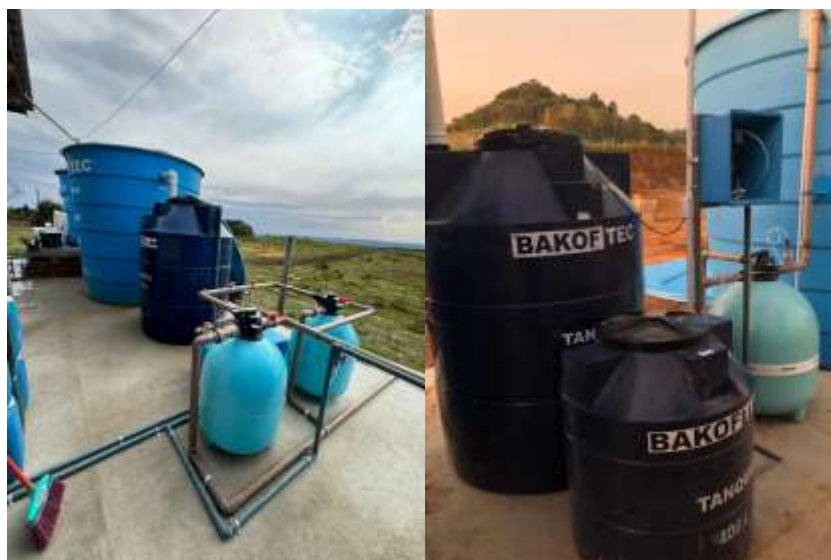
Figura 06 – Sistema de Filtração Bakof Tec.
