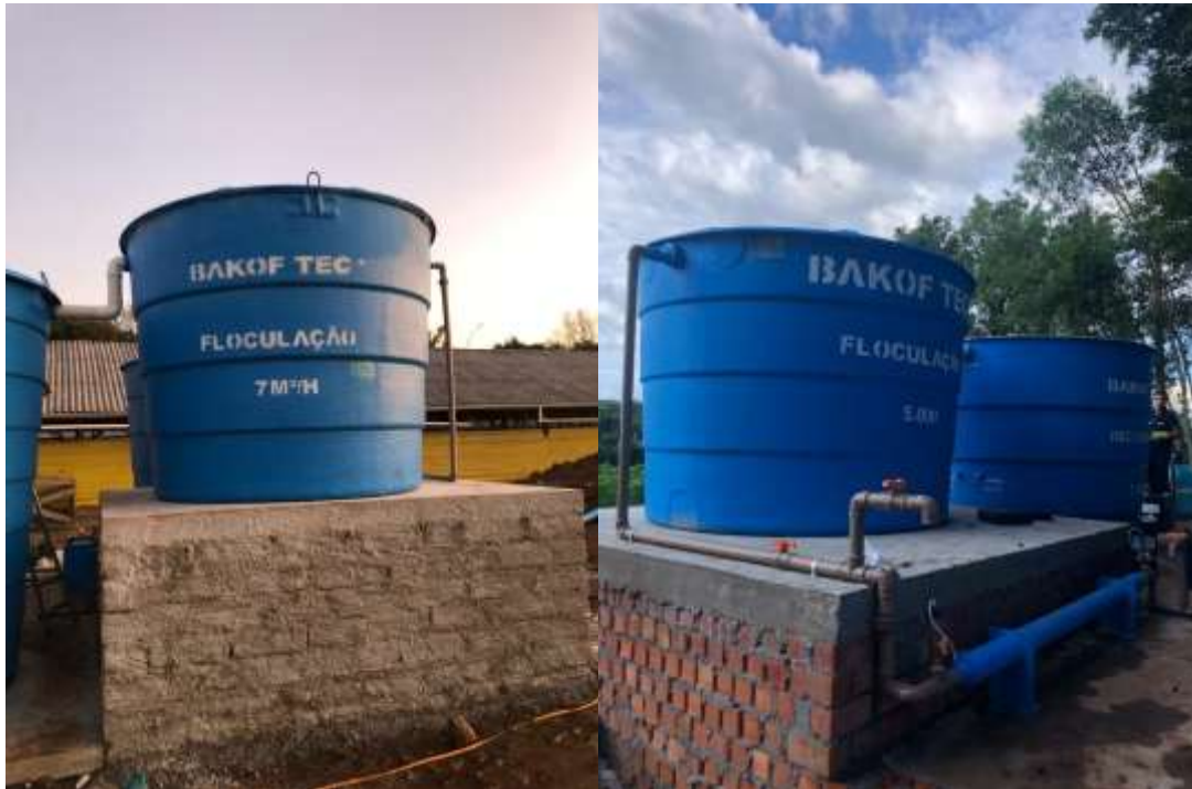
Figura 04 – Tanque de Flocação Bakof Tec.
